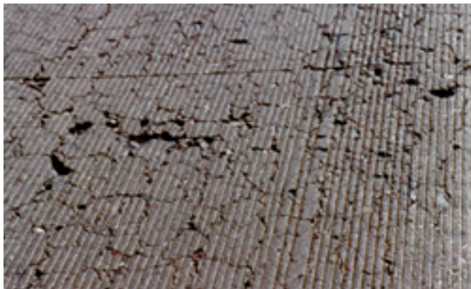
g. ASR distress
