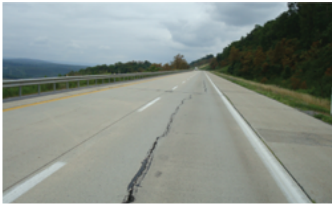
e. Longitudinal cracking
